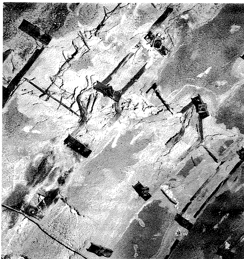
Fig. 1 : Una significativa immagine delle lesioni del sostegno di I fase.
